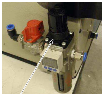
Přívod vzduchu, filtrace a regulátor
