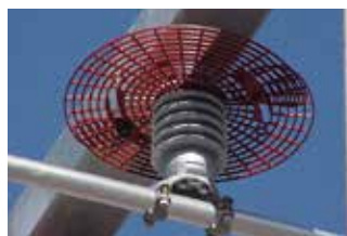
BISG-60/115-02 installé sur le support d'isolation du jeu de barres
