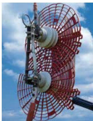
BISG-24 installation sous tension
