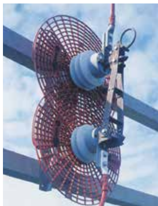
BISG-60/115-02 installé sur le sectionneur
