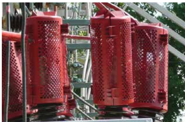
BCAC-IC installés sur les traversées
